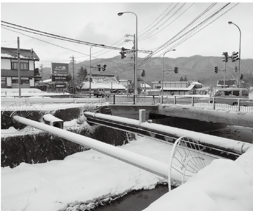
村内で法定耐用年数40年を超えている水道管は30km 大川橋横にある管路は大丈夫か
