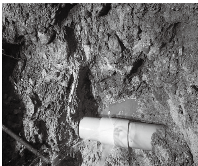
【配水管の漏水】
