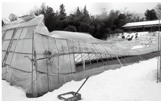
積雪による被害
