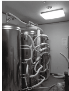
タンク3基にボイラーで作ったお湯を貯め、 お風呂と給湯、全館暖房に利用している
