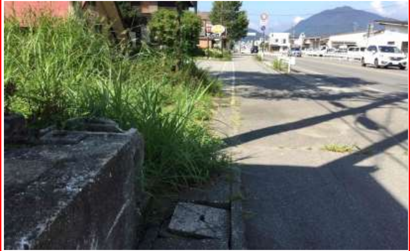
国道148号沿い歩道・・・破損している側溝の修繕
