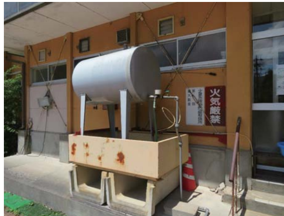
外部 オイルタンク(北)
