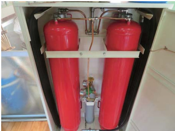
パッケージ型消火設備(内部)
