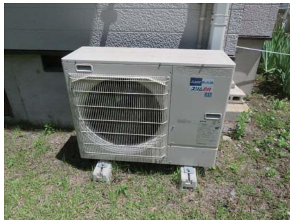
外部 エアコン室外機(支援ルーム)
