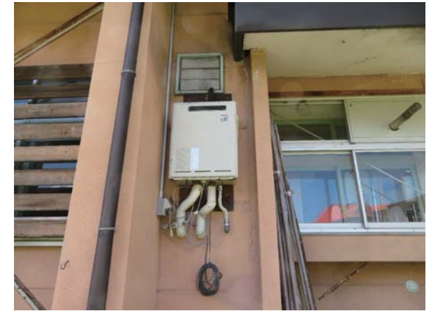
外部 ガス給湯器
