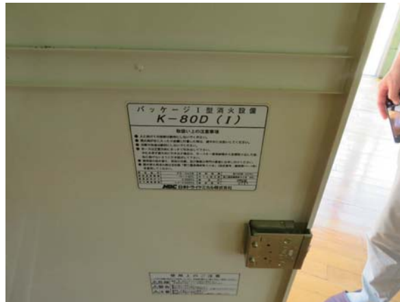
パッケージ型消火設備(内部)
