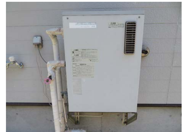
外部 石油給湯器(支援ルーム)
