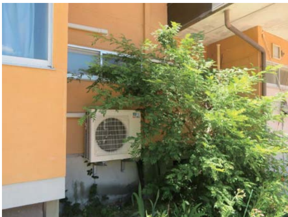
外部 エアコン室外機(乳児室)
