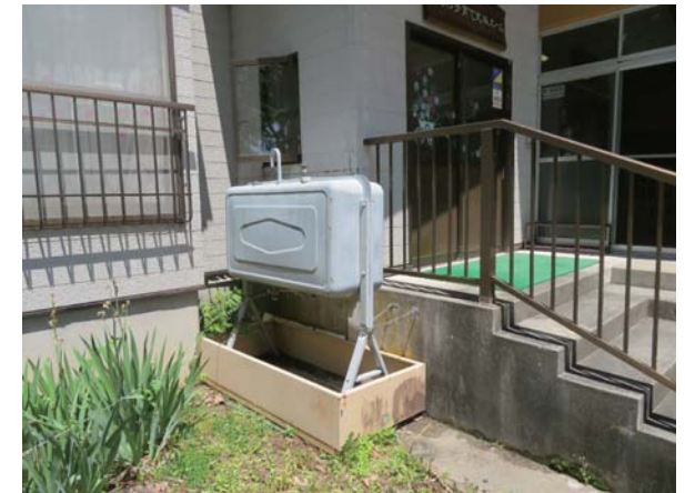
外部 オイルタンク(支援ルーム)
