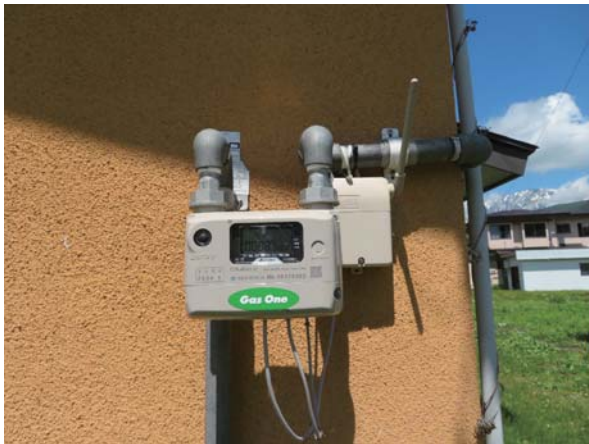
外部 ガスメーター
