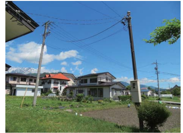
外部 電気引込みポール
