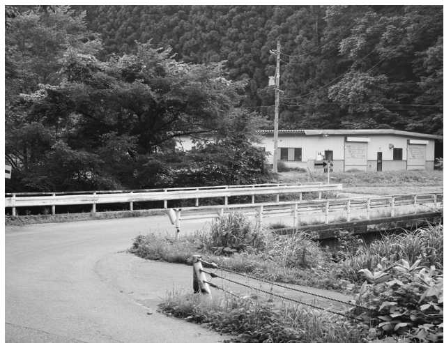
老朽化により架け替えが必要な楠川橋
