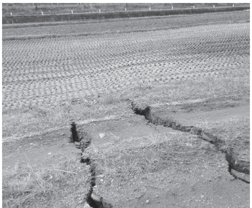
ひび割れ、隆起した農地(神城地区)
