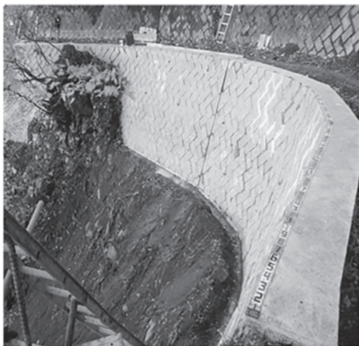
岩盤露出により1000万円減額になった災害復旧工事(立の間)
