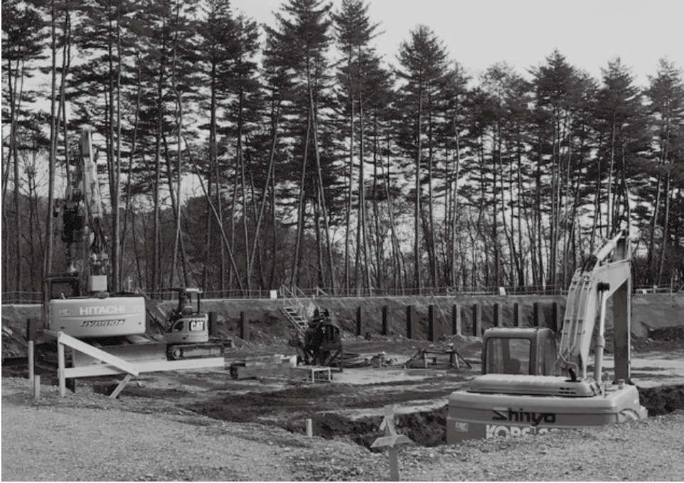
広域連合への負担金6億6600万円を計上 工事が進む大町市源及地区の新ごみ焼却施設現場
