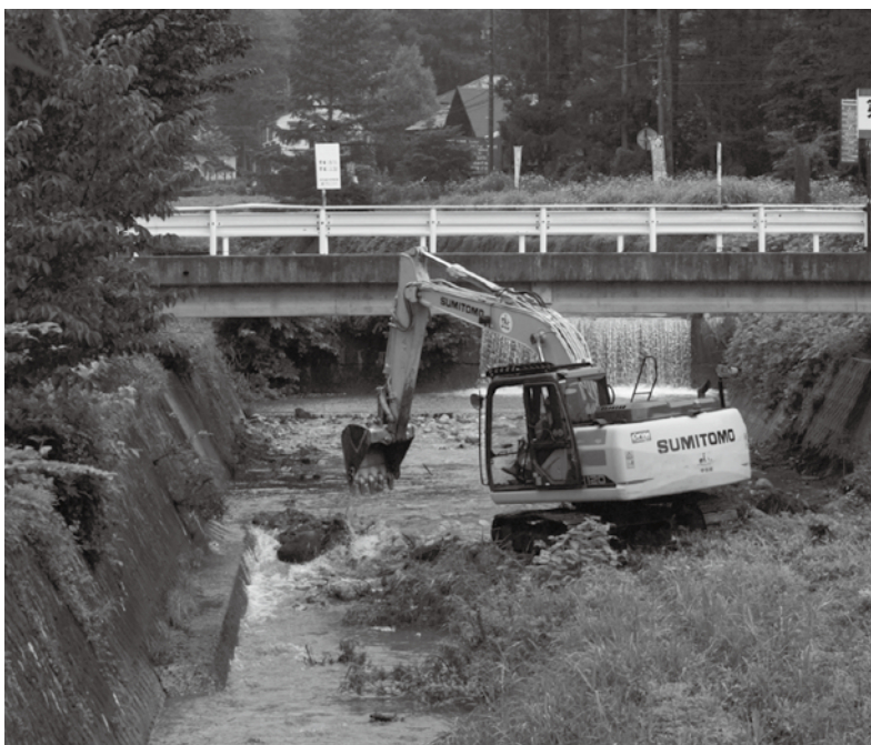
犬川にバックホーが入り、中洲の整備が行われた。これにより防災と、区民が川に入っの草刈作業から解放
