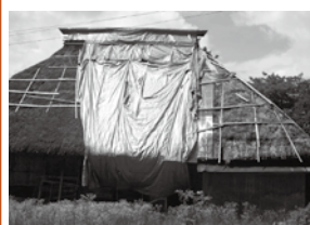
今にも崩れ落ちそうな特定空き家(廃屋)とみられる建物(岩岳地区)観光地として景観対策が急務ではないだろうか。
