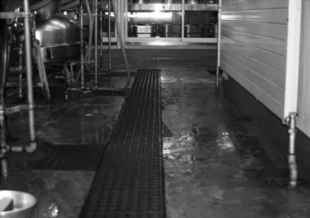
老朽化が進む学校給食共同調理場
