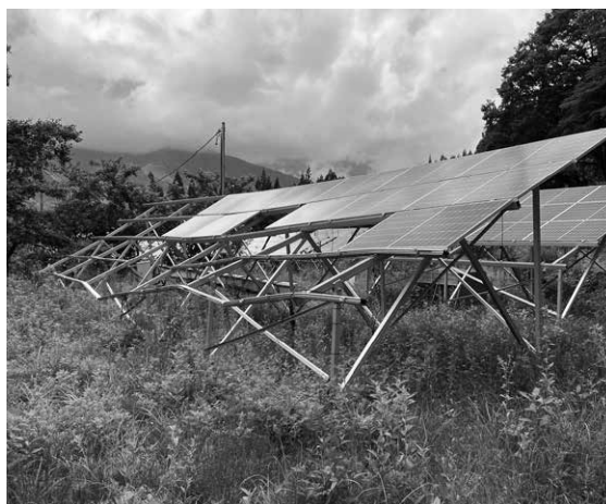
2020年ごろに設置された施設。雪で壊れている箇所も見られる
