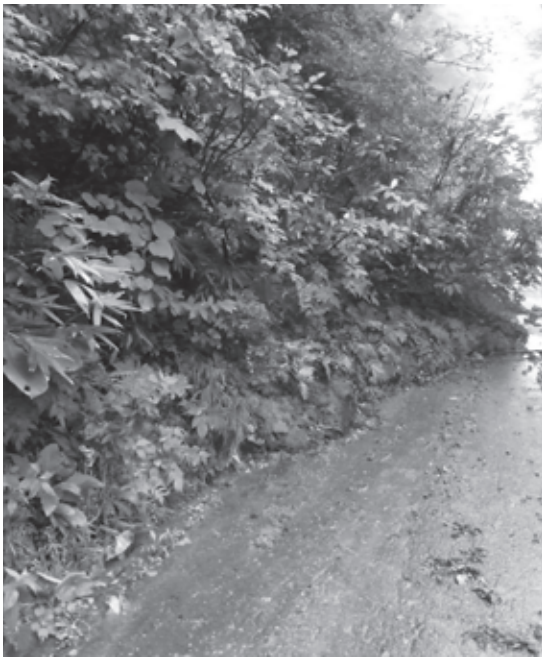
台風で崩落した林道細野線上部
