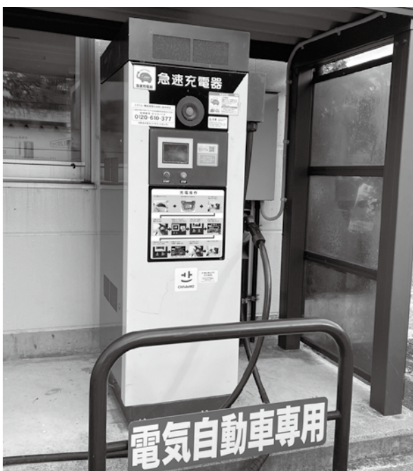
役場敷地内にあるEV用急速充電器 現在の25kwから90kwへの更新が待たれる
