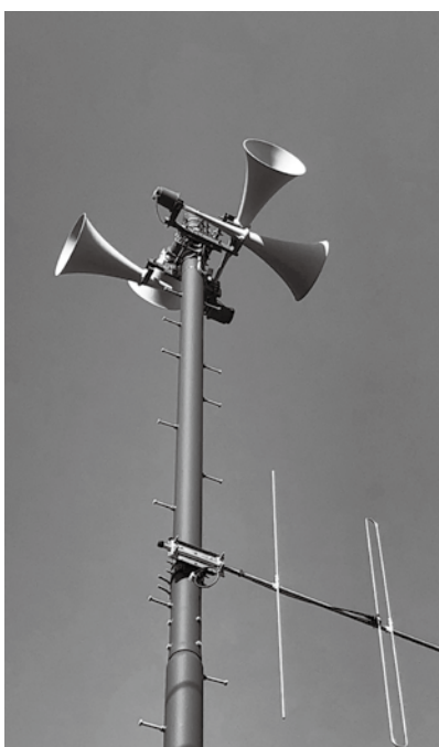
屋外スピーカーが設置されず、防災放送がされない地区があってもいいのだろうか。
