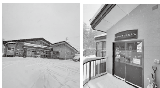
築45年経過による老朽化が激しい子育て支援ルーム。早急な対応が必要！
