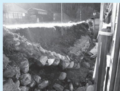
③畦畔の崩落
