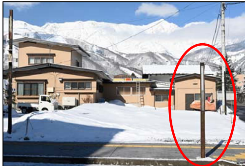
▲新設された街路灯（正面、国道歩道部）
