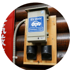
200V コンセントの一例
