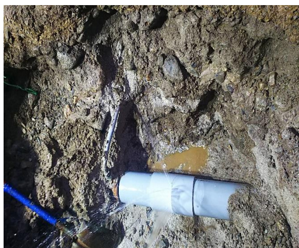
【配水管の漏水】
