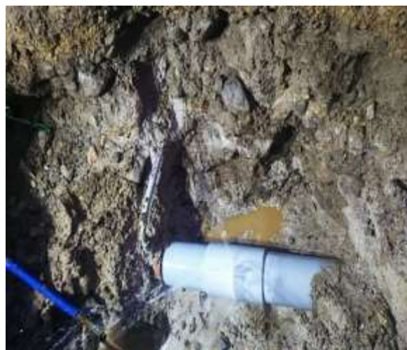
【配水管の漏水】
