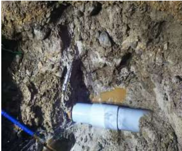
【配水管の漏水】
