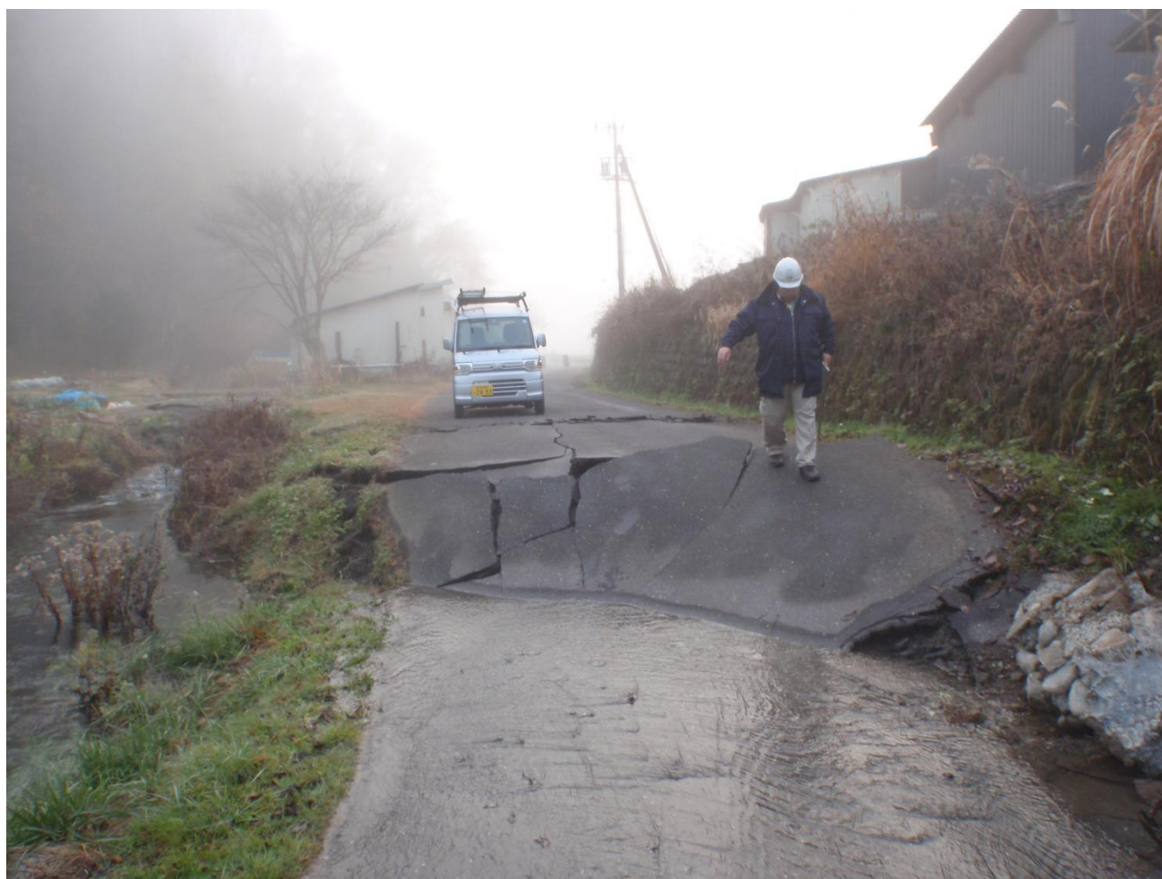
写真6-1 H26 神城断層地震後に陥没した村内の道路 (配水用ポリエチレンパイプシステム協会(POLITEC) 提供)
