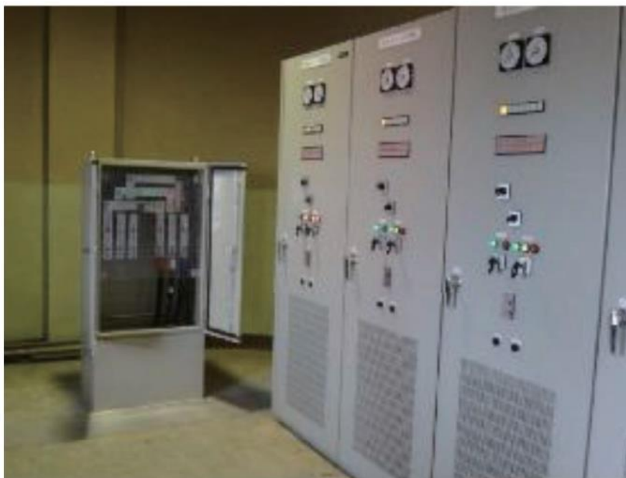
写真6-3 可搬式仮設発電機から給電を受ける接続端子 (水道施設耐震工法指針・解説 2022年版Ⅱ 参考資料編)
