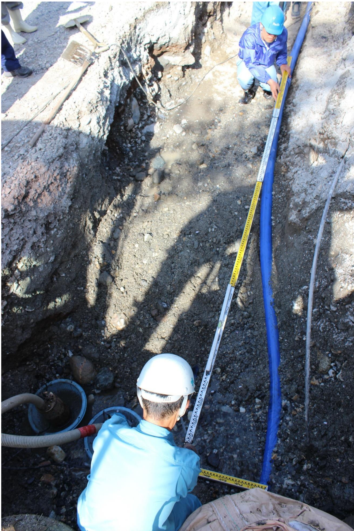
写真6-2 陥没した道路でも破断せずに通水機能を維持している配水用ポリエチレン管 (配水用ポリエチレンパイプシステム協会(POLITEC) 提供)
