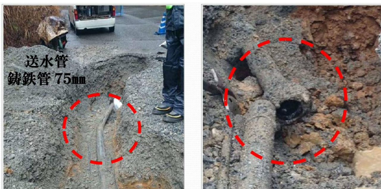
写真4-2 2014年神城断層地震で被災した嶺方地区送水管 (長野県企業局 撮影)
